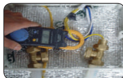
7. 전기테스트 전원공급 후 소비전력 및 발열 량 체크
